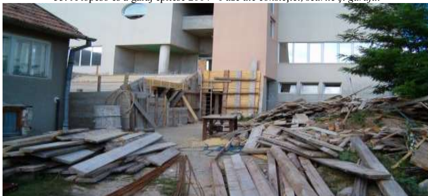
56. A lőpcső és a garáj építése 2004 - Faze ale constcției, scările și garajul
